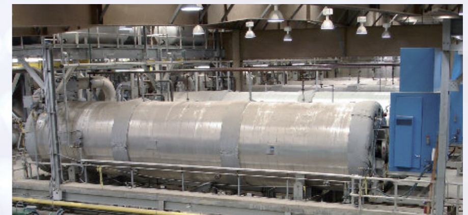
Установка для сушки шламов в США
